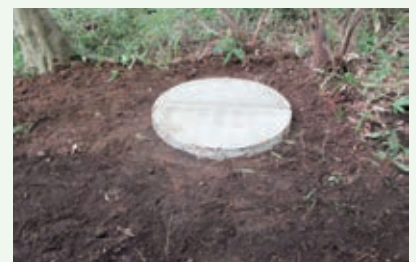
新設された浸透槽
