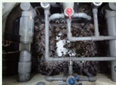
ブロワ交換工事前の内部 空気が送られずに浄化槽内が 循環されず汚水が溜まった状態
