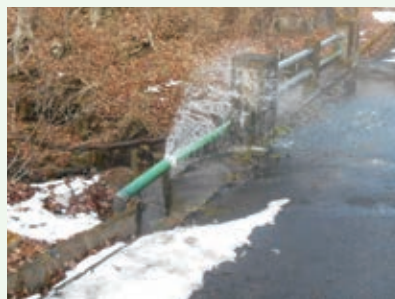
漏湯現場 発見時 (上の原高原別荘地)
