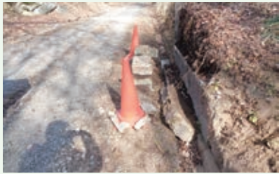
2月14日撮影 地震による崩落 (那珂川八期別荘地)
