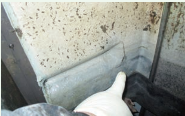
浄化槽内の亀裂箇所
