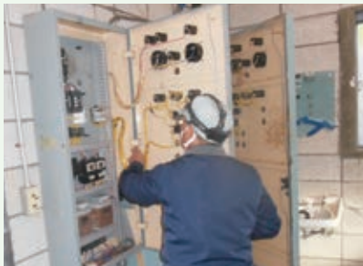
水源制御盤 調査実施 (景勝苑別荘地)
