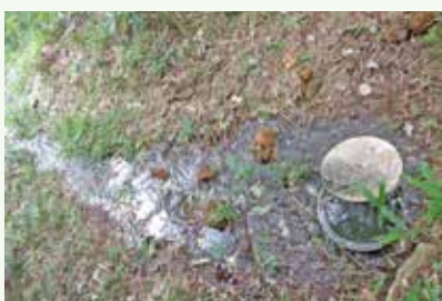
浸透せずに溢れた古い浸透槽
