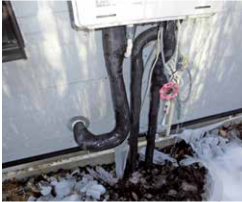
凍結破損した給湯器
