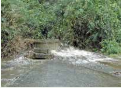
グレートハイランド別荘地の側溝溢れ
