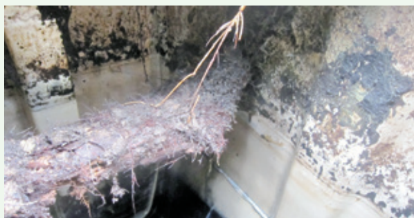
浄化槽内部を突き抜けた木の根
