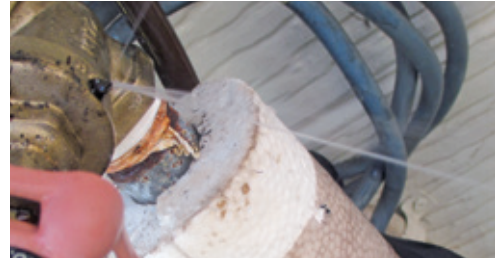
給湯器配管からの漏水 (ピンホール)
