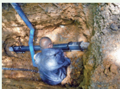
給水管漏水修理工事作業中 (グレートハイランド別荘地)
