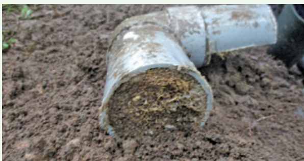
排水管 根で詰まった管の断面
