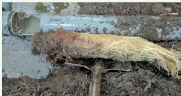
排水管内から取り出した根
