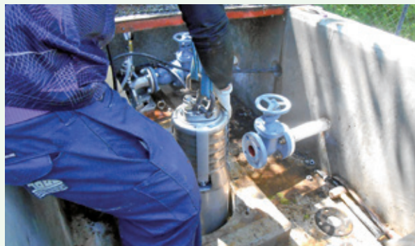
水源送水ポンプ交換工事作業中 (令和5年5月16日 那珂川別荘地)
