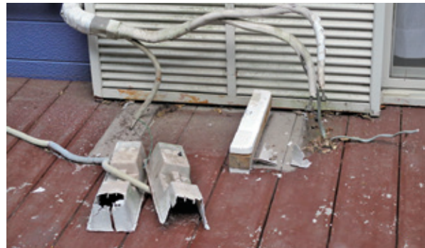
室外機が盗まれた現場写真 (6月26日)
