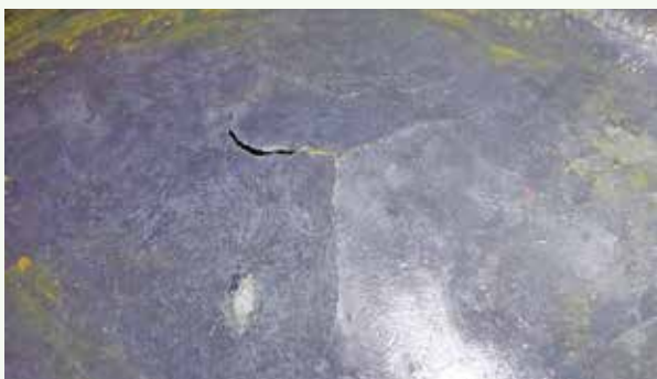
浄化槽内部の亀裂部分
