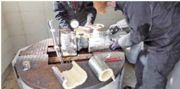
水源井戸ポンプチャッキ弁交換工事 作業中 (桜台別荘地)
