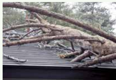
隣地の屋根への倒木状況 (湯の里村別荘地)
