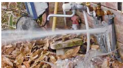
蛇口の凍結破裂状況
