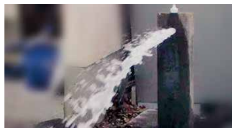
散水栓の凍結破裂により蛇口が飛んだ状況
