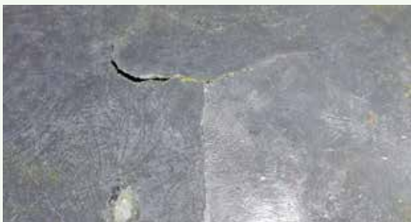
浄化槽内部の亀裂状況
