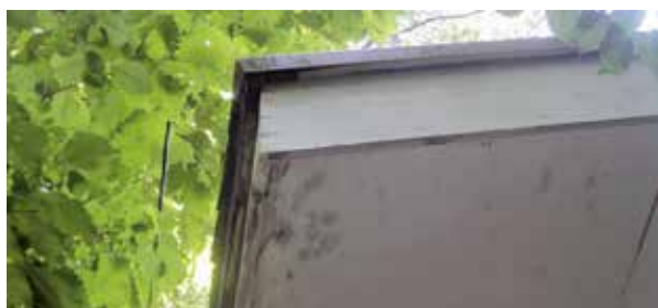
雨漏り等の軒天の汚れ状況
