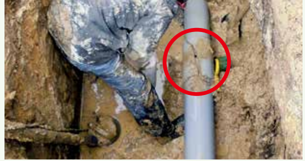
配水管の老朽による漏水を発見し、 漏水修理工事 作業中
