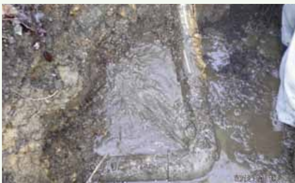
漏水現場 (吉野台)
