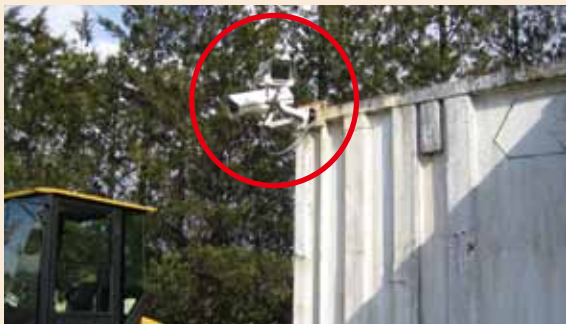
パケイションランド管理事務所ゴミステーション監視カメラ
