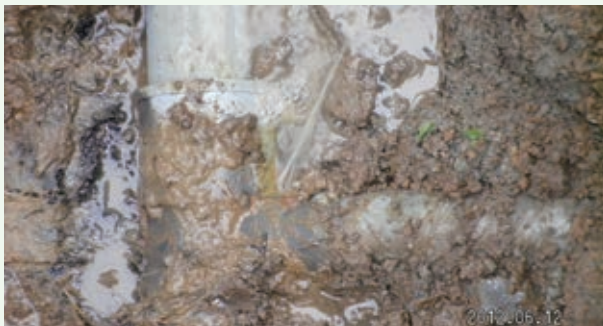
漏水箇所（那珂川）
