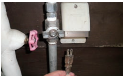
給湯器コンセント
