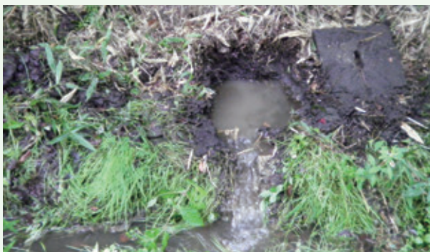
漏水現場（吉野台）
