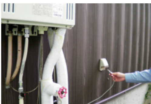
給湯器の落雷被害の防止
