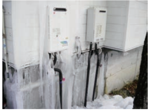
給湯器凍結による破損事例
