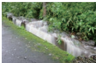
大雨後の側溝
