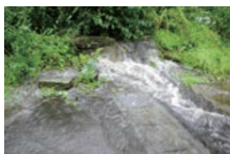
台風通過後の側溝
