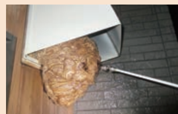
換気扇ダクトに出来たスズメバチの巣
