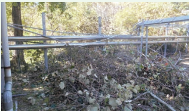
隣地の倒木によりケーブル線が破損（第二緑泉苑）
