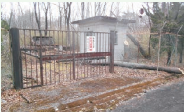
倒木によりケーブル線が破損（山吹台9期）
