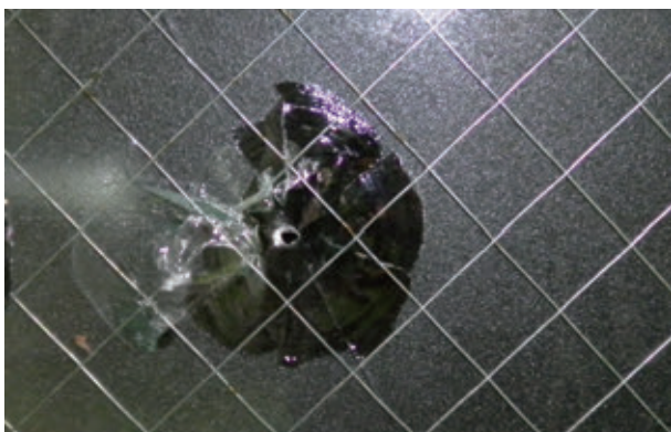
玄関ガラス破損
