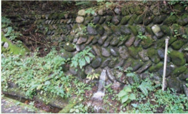
水源からの送水管漏水状態（八方高原）
