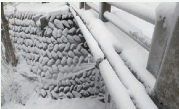
橋の部分の漏水（上の原高原）
