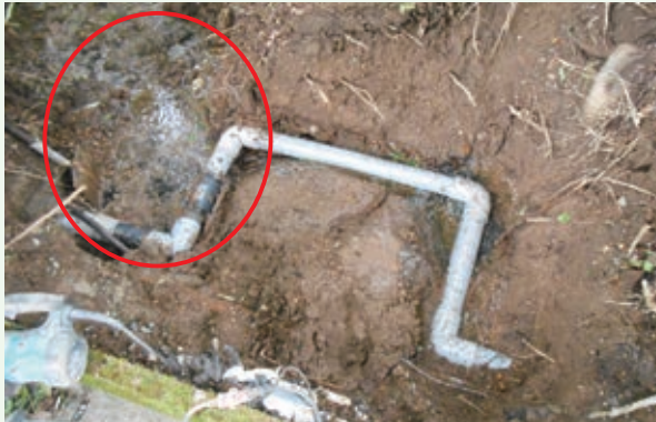
漏水現場（上の原高原）
