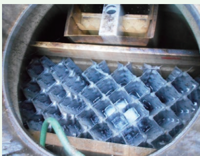
②浄化槽内の水位低下
