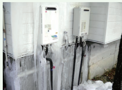
凍結破損した給湯器の事例
