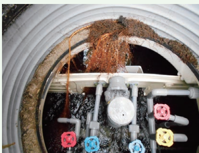
①浄化槽内に根が入り込んだ状態
