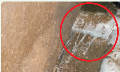
配管破損部分
