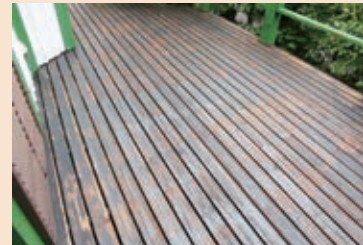
高圧洗浄にて塗装が剥がれたデッキ
