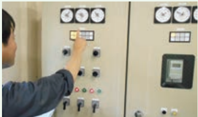
制御盤の定期点検 (レークサイド別荘地)
