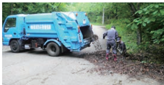
側溝は縁の下の力持ち、重要です 台風や大雨に対応しております
