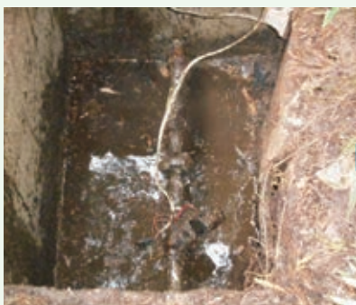
水道施設内の漏水現場 (景勝苑別荘地)
