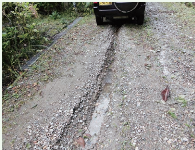
砂利の流出した道路 10月13日撮影 (グレートハイランド別荘地)
