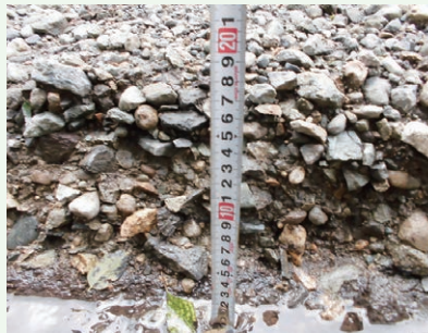
流出した深さ 10月13日撮影 (グレートハイランド別荘地)
