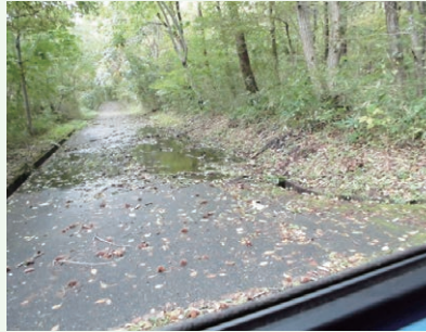
冠水した道路 10月13日撮影 (桜台別荘地)
