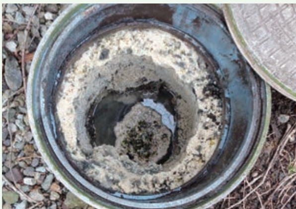
雑排枳内の凝固した油分 （内部の白い部分が全て排油です）
