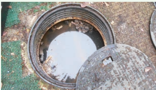
浄化槽に水が逆流し水位が上昇した状況
